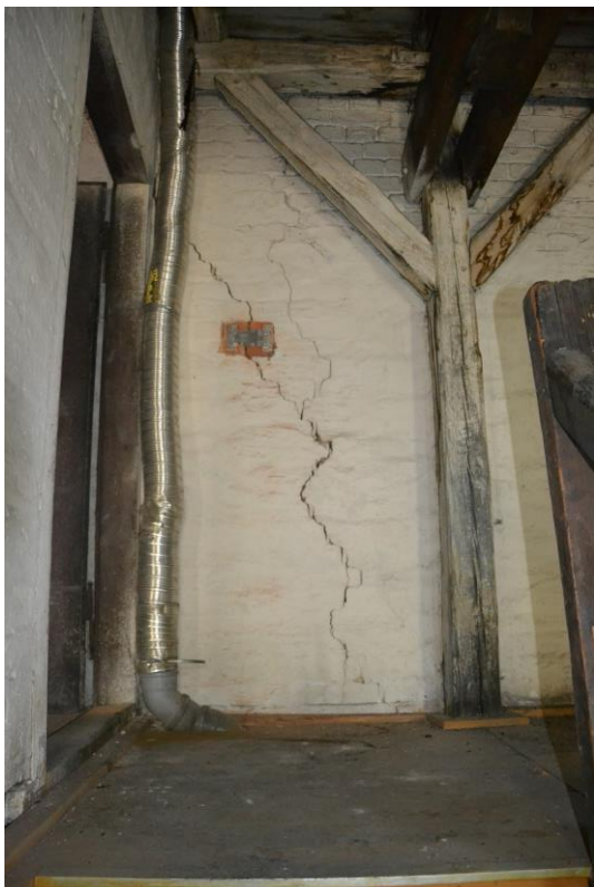
Fot. 19. Rysomierz zamontowany na ścianie naprzeciw schodów [1.6].
