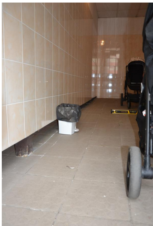
Fot. 16. Nierówna posadzka w pomieszczeniu wózkowni – kilkuspadkowa powierzchnia po długości pomieszczenia w kierunku drzwi o wartości pochylenia od 1 do 5% [1.6].
