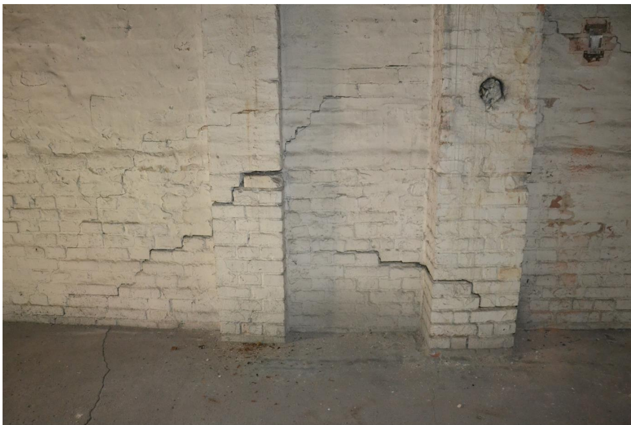
Fot. 18. Zarysowanie ściany wschodniej. Skośne rysy obejmujące ścianę, przyległy filarek i komin [1.6].
