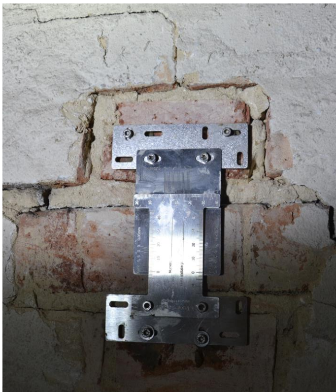
Fot. 22. Rysomierz zamontowany na ścianie przy filarku i kominie. Wynik rozwarcia 0 mm [1.6].
