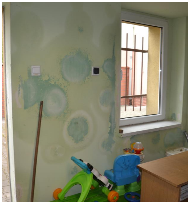
Fot. 12. Widok zawilgocenia ściany parteru części zachodniej budynku gospodarczego [1.6].
