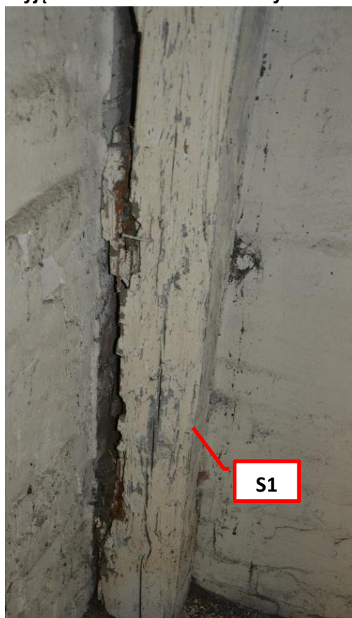
Fot. 24. Zbliwienie na uszkodzony słup w narożu budynku [1.6].
