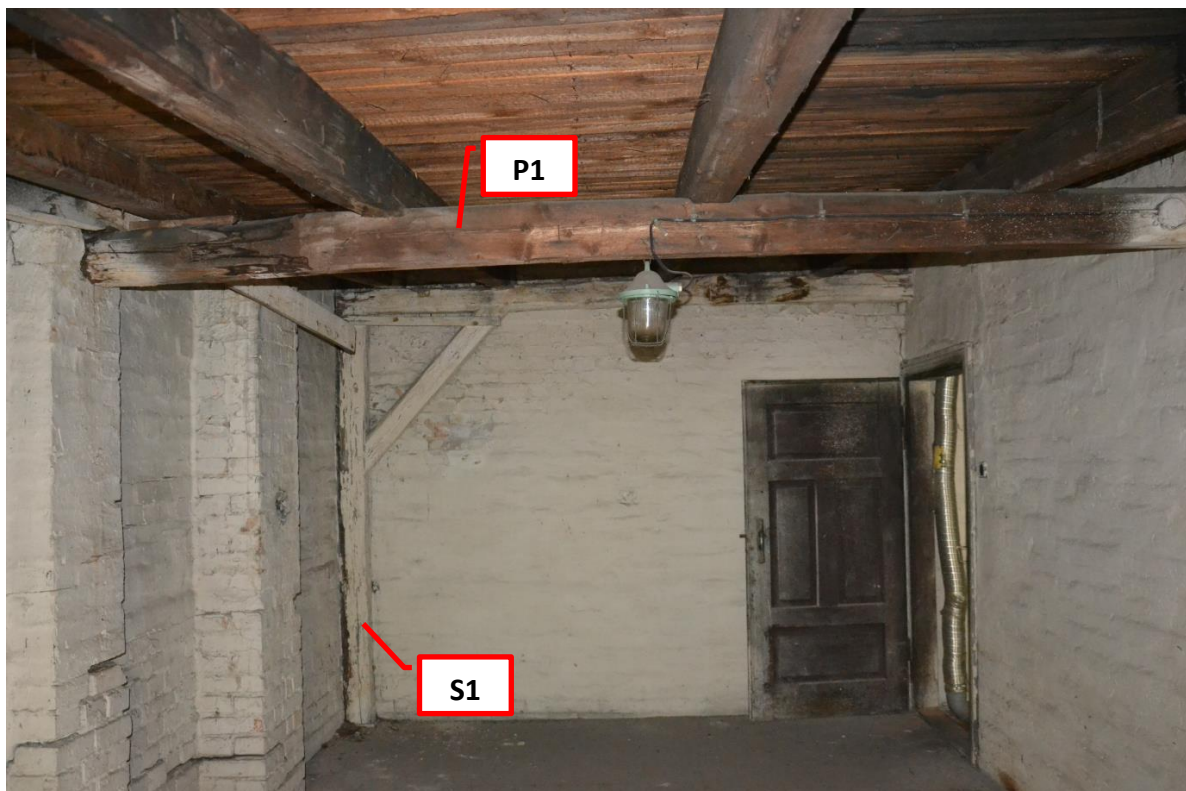
Fot. 23. Widok pomieszczenia w części wschodniej poddasza budynku gospodarczego. Przyjęte oznaczenia uszkodzonych elementów konstrukcji dachu: P1 – łąaw, S1 – słup [1.6].
