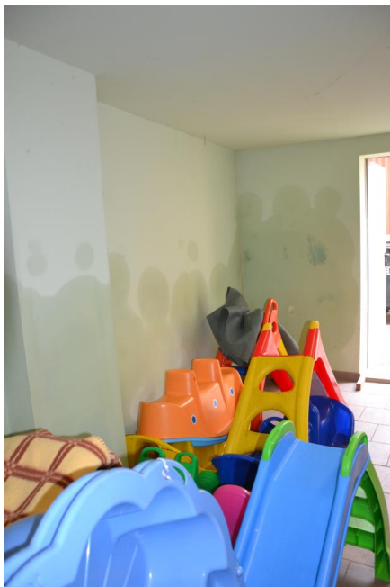
Fot. 11. Widok zawilgocenia ściany parteru części zachodniej budynku gospodarczego [1.6].
