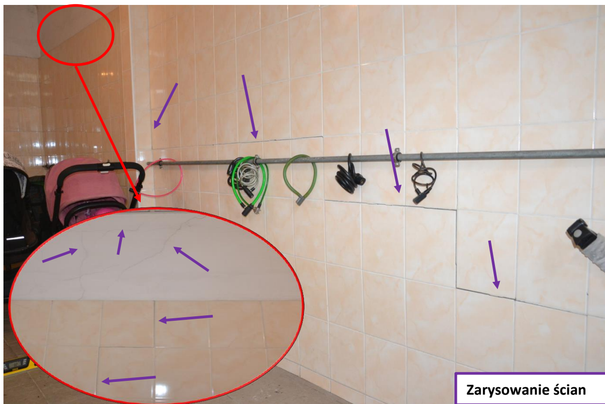
Fot. 15. Zarysowania ściany w pomieszczeniu wózkowni [1.6].
