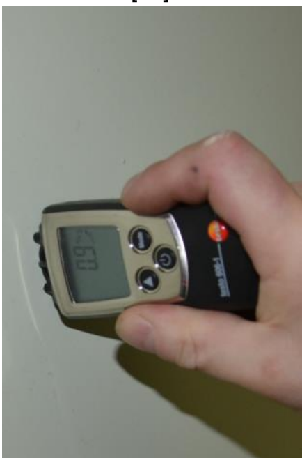
Fot. 13. Pomiar wilgotności ściany w pomieszczeniu magazynowym w górnej części tj. powyżej zacieku. Wynik 0,9 % - ściana o dopuszczalnej wilgotności [1.6].
