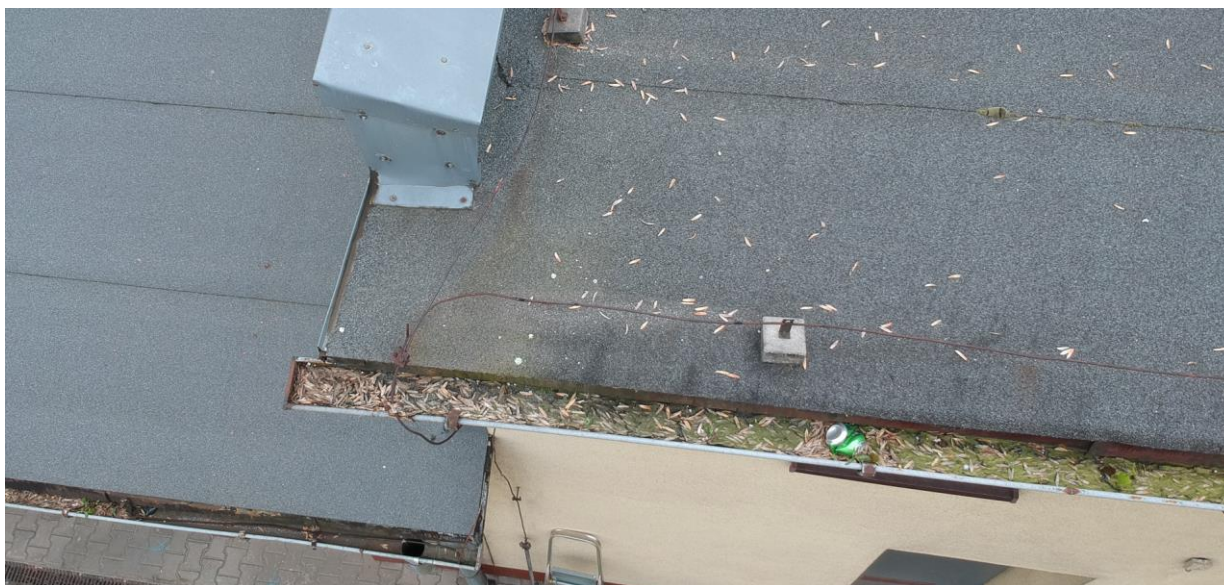
Fot. 29. Fragment dachu budynku gospodarczego z niedrożną rynną [1.6].
