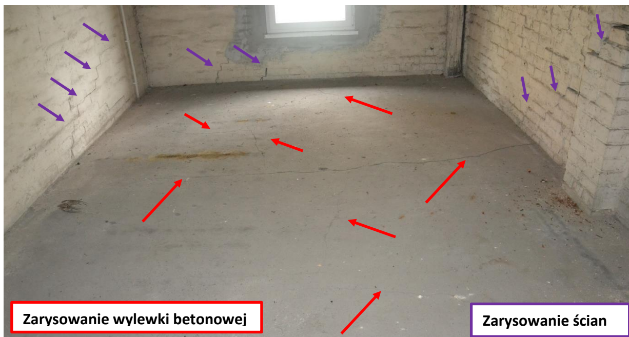
Fot. 17. Zarysowanie rozgałęzione zarysowania posadzki oraz skośne rysy ścian [1.6].
