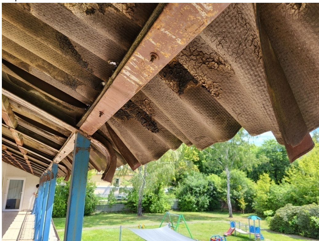
fot 5 Widoczne zdeformowane płyty zadaszenia -brak rynny
