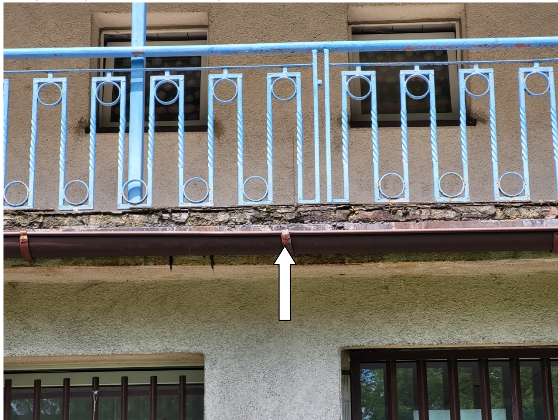
fot 3 Widoczne rozwarstwione obrzeże tarasu – brak obróbki okapowej
