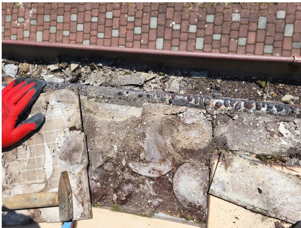
fot 4 Widoczne dwie warstwy płytek -brak obróbki okapowej blacharskiej
